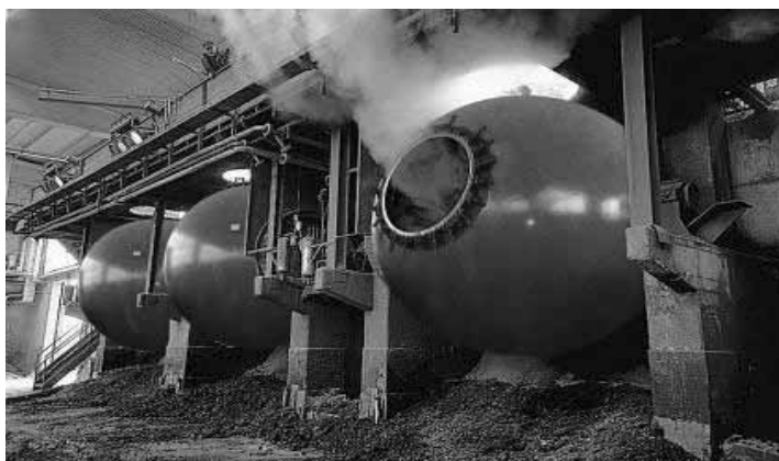
Impianto di idrolisi termica – ILSA spa Arzignano (VI)
